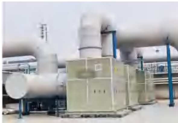
污水处理异味治理引风机
